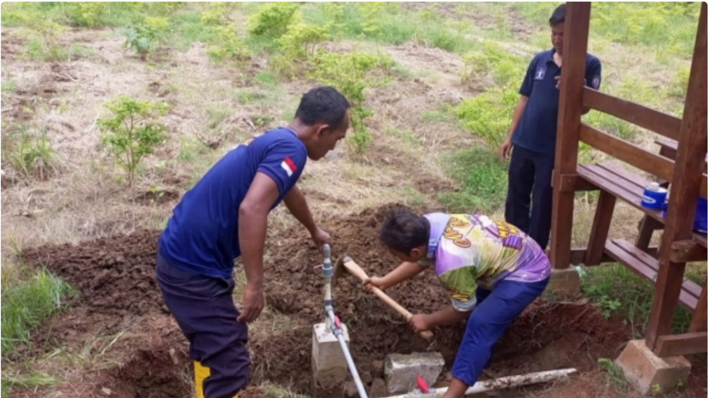
Rutin Rawat Pompa Air, Lapas Terbuka Kendal Jamin Ketersediaan Air Bersih
